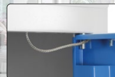
Mise à la terre de chaque porte
