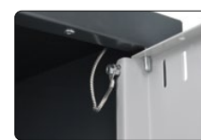
Mise à la terre de chaque porte
